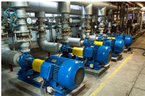
Сл. 41 Пумпна постројења
